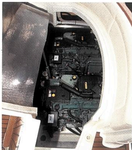
La sala de máquinas está bien aislada, tanto por lo que hace a la emisión de ruidos como a la entrada de agua.
