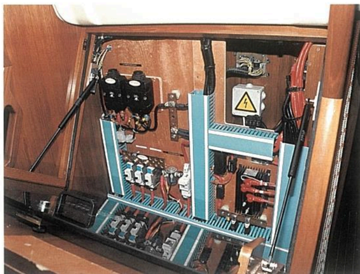
El tablero eléctrico ofrece total seguridad.
